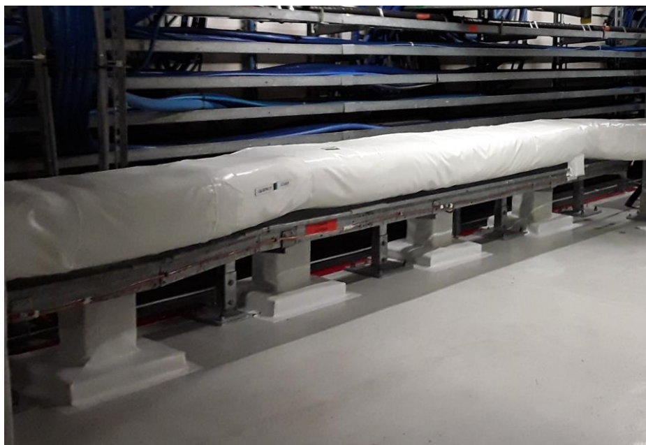
Figure 6. Exemple de protection de chemin de câble
