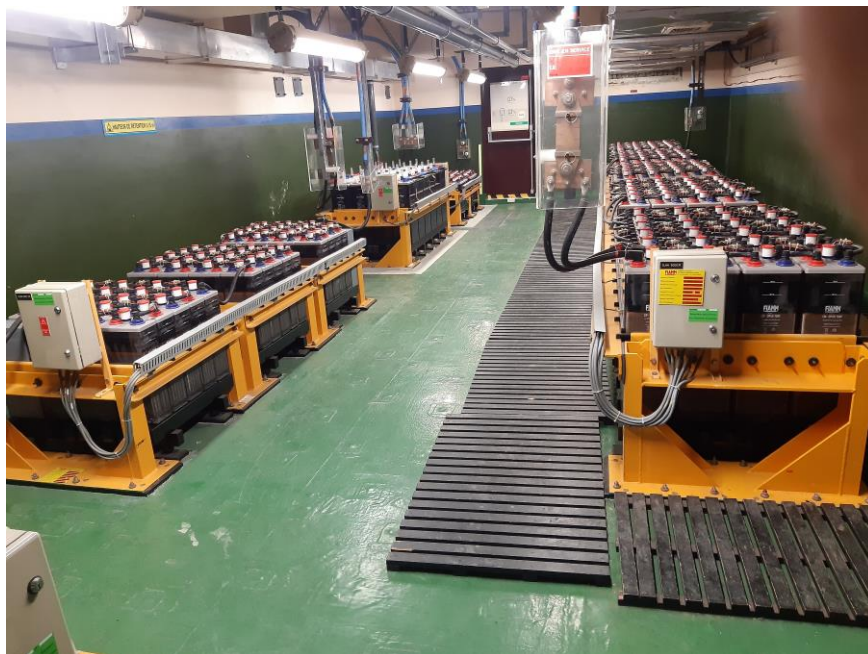
Figure 8. Photo des locaux contenant les batteries
